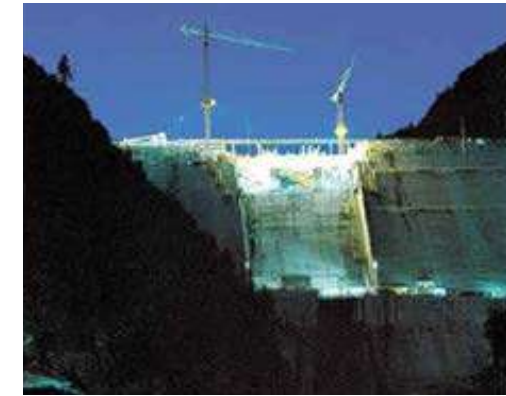
FIGURA 3.100 CENTRAL HIDROELÉCTRICA RALCO
